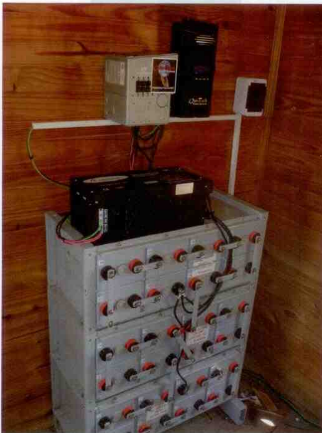
Fuente: Superintendencia de Energías Renovables Itaipu Binacional - 2013
